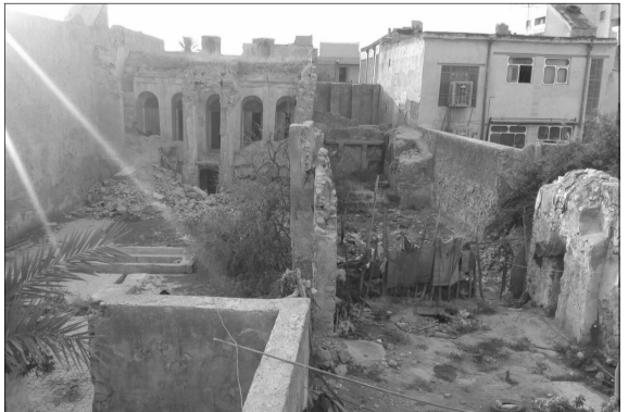
تخریب ۲ بلاک خانه مخروبه واقع در خیابان شهدای شمالی کوچه مختاری - جمعه ۹۴/۵/۹
