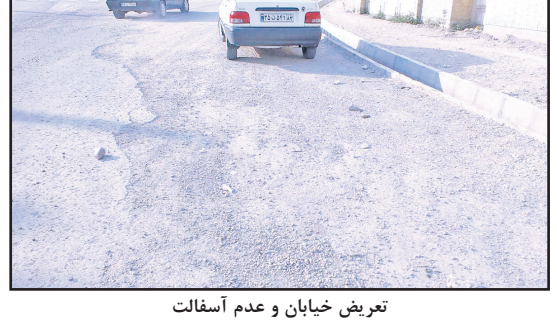
تعریض خیابان و عدم آسفالت
