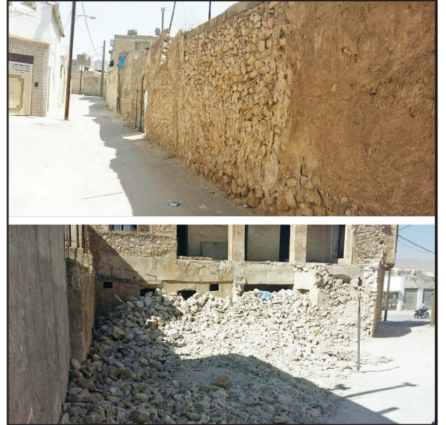
ایمن سازی مسیر دیوار در حال تخریب واقع در کوچه روزی طلب
